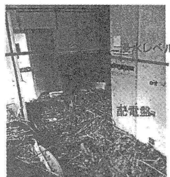
写真 2 発電所の被害
