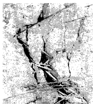
図-6 ひび割れ写真
