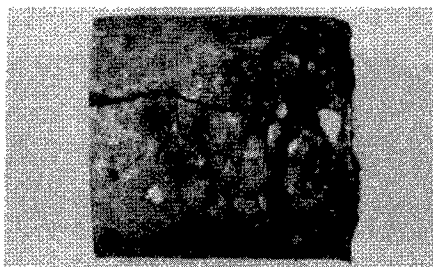
写真-2 コンクリートコアのひび割れ
