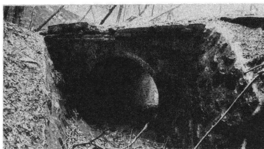
写真3 凍結融解による煉瓦剥離欠損
