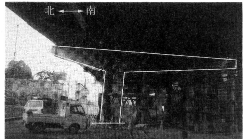
写真-1 P352 の損傷状況
