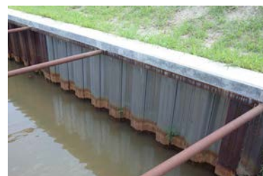
図 1 鋼矢板暴露状況
