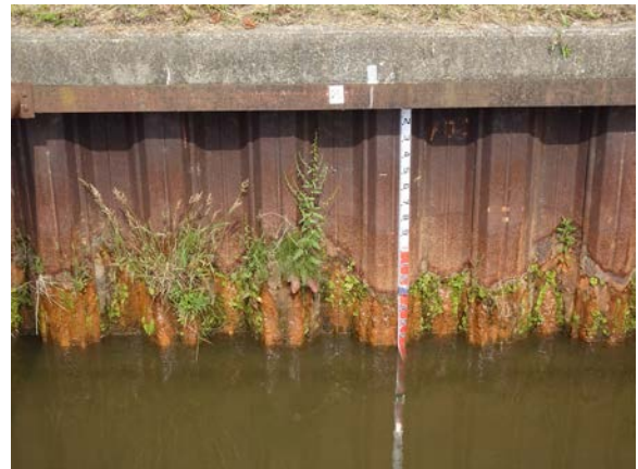
図-1 解析画像 (既設鋼矢板護岸の可視画像)
