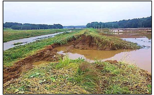
写真-1 藤井川破堤箇所
