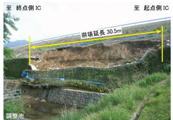
図-2 補強土壁の崩壊状況
