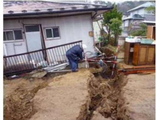
図-1 宅地地盤のクラック 1)
