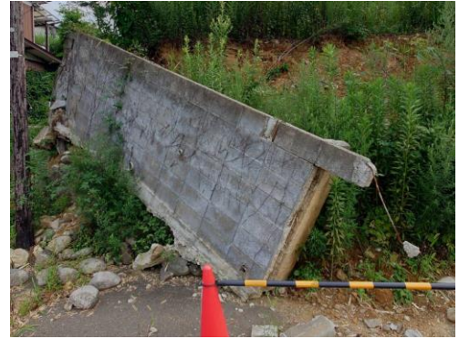
写真-1 地震によって崩壊した擁壁
