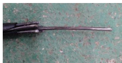
写真-2 ケーブルの破断
