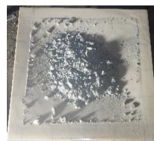
図-5 捕捉したコンクリート片
