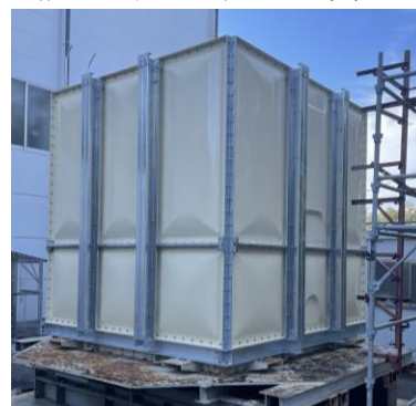
写真-1 FRP製タンク
