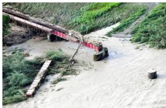
図-1 流出した球磨川第四橋梁
