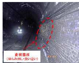
写真-⑤ 側壁変状
