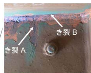
図-6 き裂発生箇所
