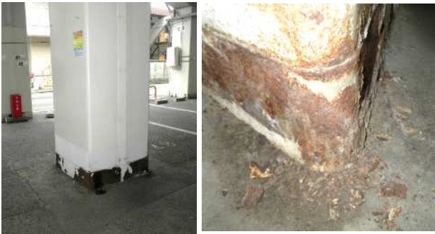
図1. 鋼板巻補強箇所の地際部における腐食
