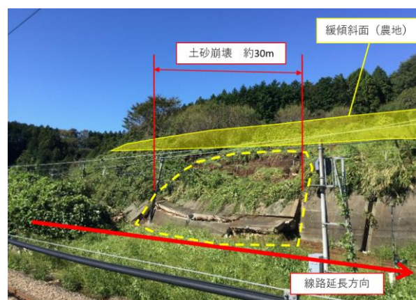
写真2 災害発生翌日の様子（土留壁崩壊）
