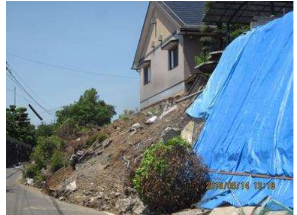
写真-1 熊本地震による被害 1)
