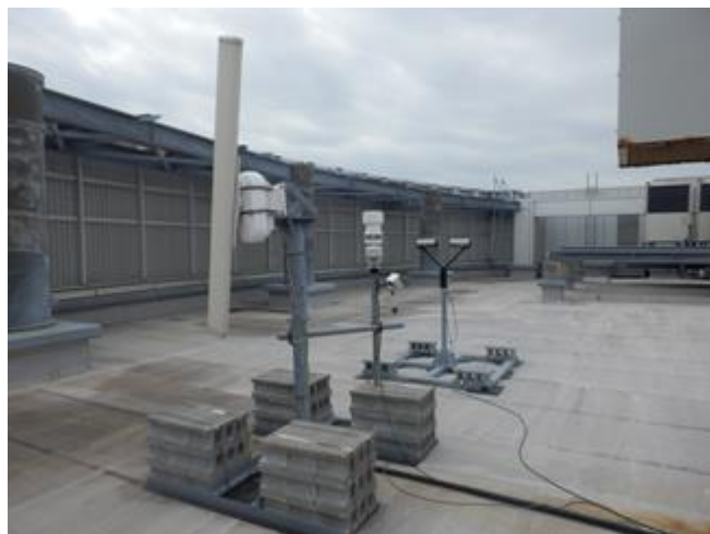
図-1 マリンレーダーの設置状況
