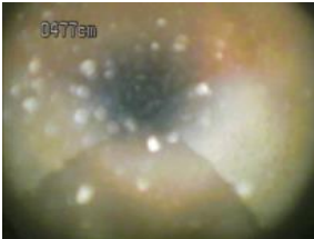
写真1 管内の堆積物
