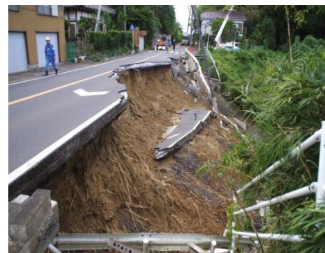
写真-1 盛土斜面の崩壊
