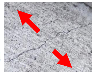
写真-1 土間コンクリートのクラック
