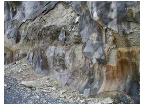
写真-1 モルタルの劣化による剥離 2)
