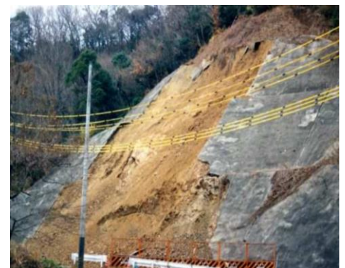
写真-2 土砂化による法面崩壊 1)
