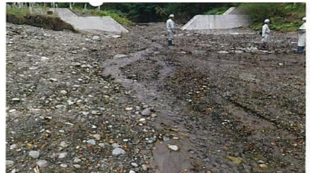
写真4 平成28年度台風通過後の減勢工の状況
