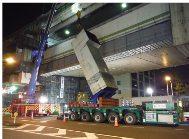
写真-3 上層柱ブロックの横倒し状況
