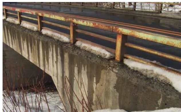
写真-1 凍害・塩害複合劣化を起こした橋梁 1)
