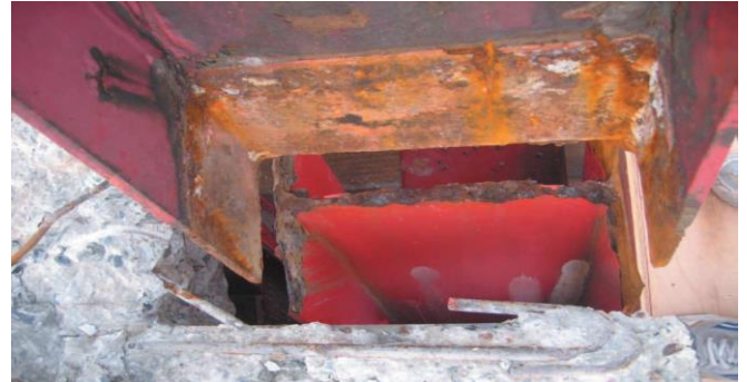
図-1 木曽川大橋の破断部分
