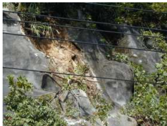
写真-1 モルタルの劣化による剥離
