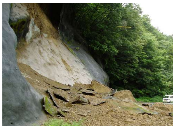
写真-2 地山土砂化による法面崩壊
