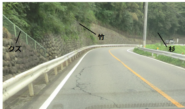
写真1 路面のひび割れと植生
