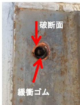
図-2 破断箇所状況
