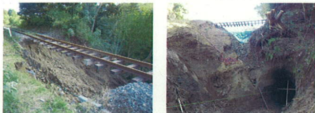
図 1. 土砂崩壊状況
