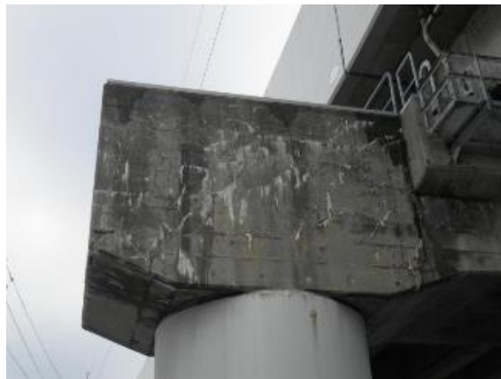
図-1 ASR による変状状況
