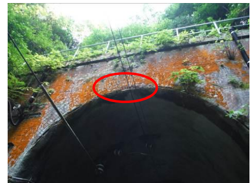
写真-4 レンガ造覆工剥落状況（遠景）
