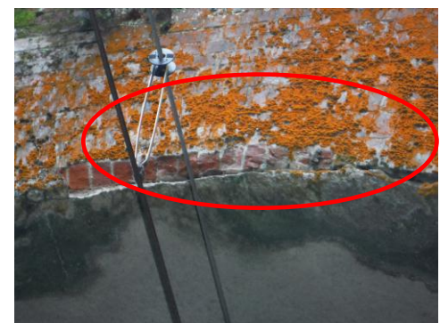
写真-5 レンガ造覆工剥落状況（近景）
