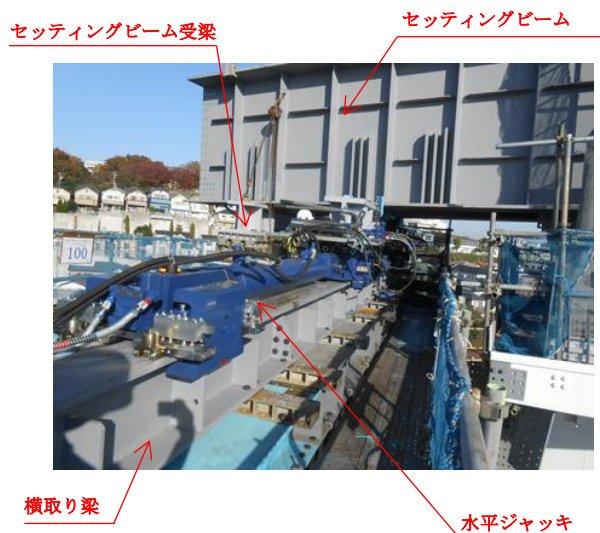
写真-1 横取り設備（起点方）
