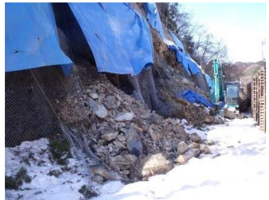
写真-2 崩壊直後の様子
