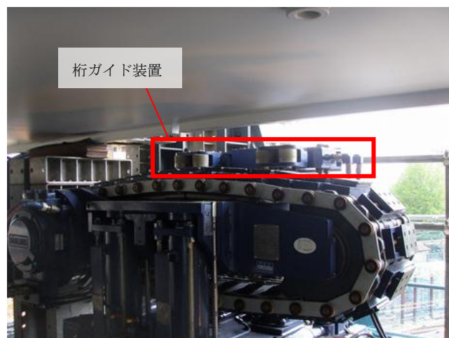
写真-1 エンドレス駆動装置および桁ガイド装置
