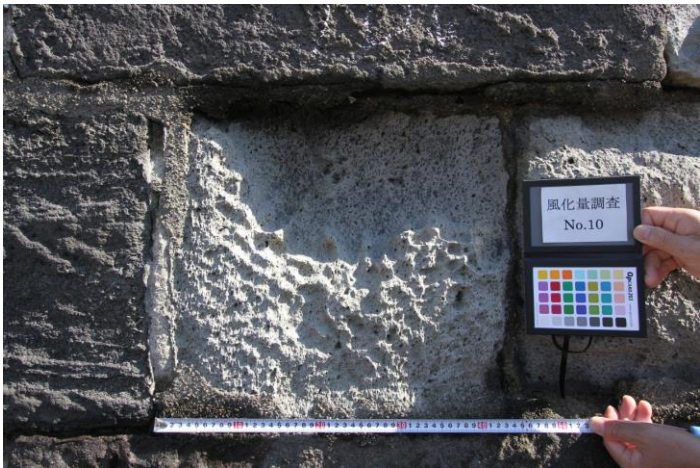
写真-3 (a) 石材の風化の状況 (No.10)
