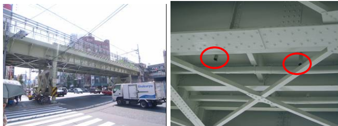
写真3 C橋りょう（左：全景 右：排水樋損傷）
