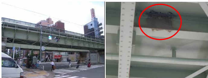
写真4 D橋りょう（左：全景 右：漏水箇所）
