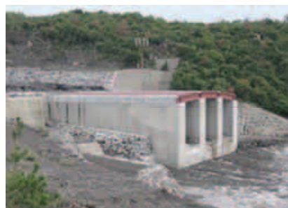
写真-1 底面水抜きスクリーン
