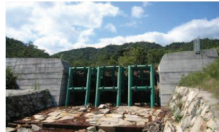
写真-1 透過型砂防堰堤
