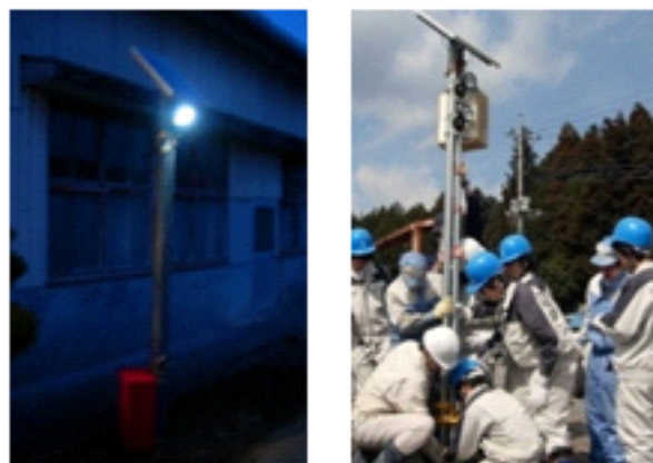
図-2 ソーラーLED街路灯の設置
