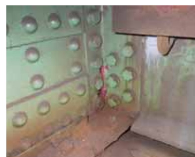
写真-2 連結山形鋼のき裂 ②
