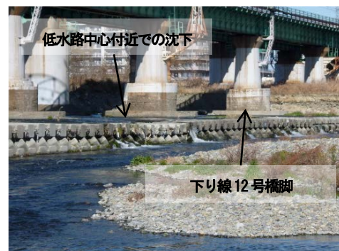
写真-4 ブロックの変状と落差
