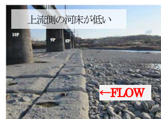
写真-3 河床低下の状況
