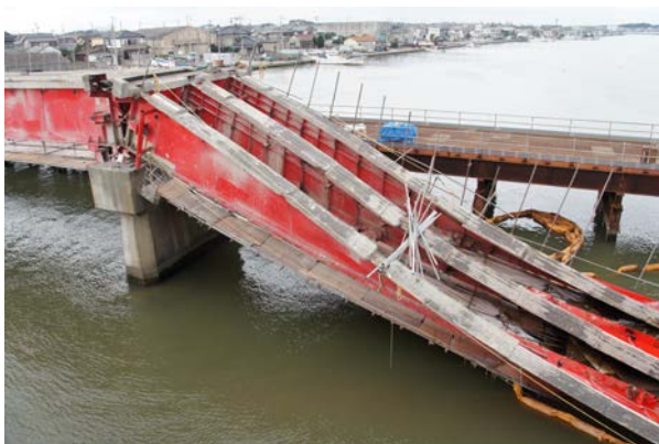
写真－1 横倒れ座屈を生じた主桁
