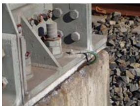
写真-1 電架柱より柱に埋め込まれた接地線
