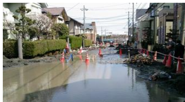
写真 1, 液状化により噴出した地盤
