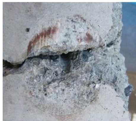
写真-2 D60PR2 の破壊状況
