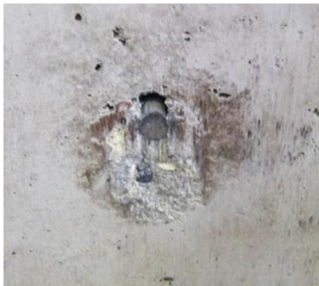
写真-1 D30PR1 の破壊状況
