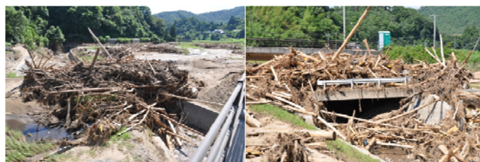
(a) 上流側から撮影 (b) 下流側から撮影 写真-1 平成22年7月の広島県庄原豪雨災害
